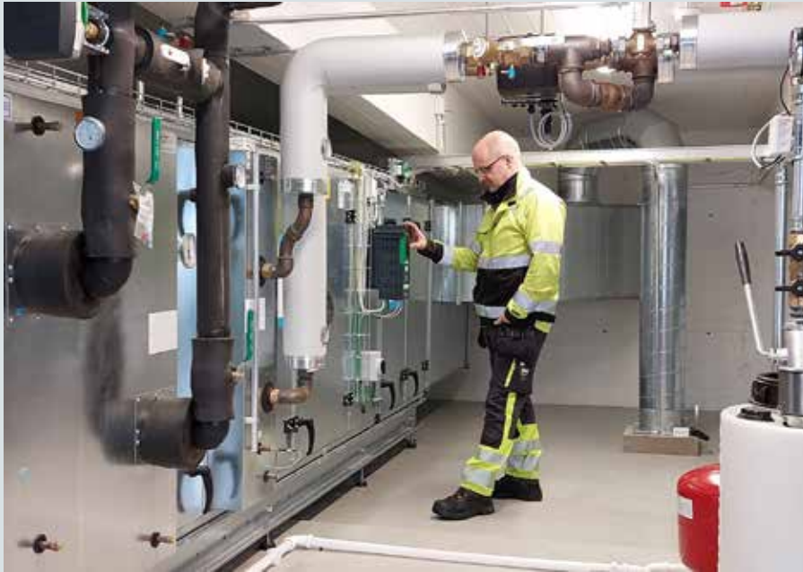
Tekninen kiinteistöhoitaja Mika Jokinen tarkastamassa Säkylän vaatetuskorjaamon ompelimon uuden ilmanvaihtokoneen asetuksia
